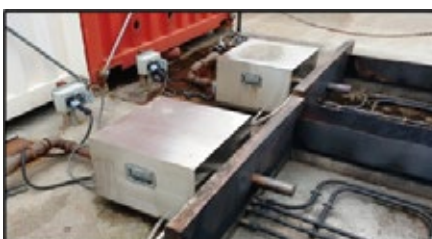
Sistema de revestimiento térmico y Sistema de fuego basado en gas – Academia de Bomberos de Nueva York. Fuente: Archivo Personal Autor
